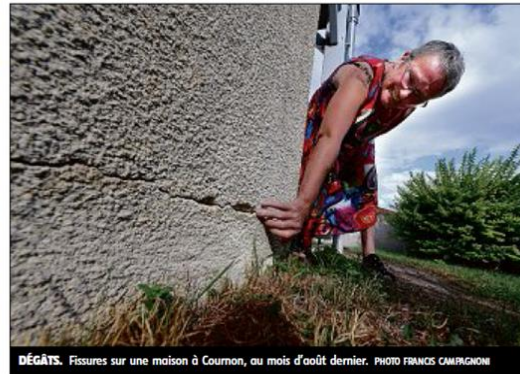
DÉGÂTS. Fissures sur une maison à Courmon, au mois d'août dernier. PHOTO FRANCIS CAMERON
